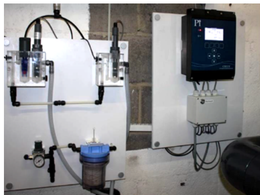
Figura 3 - Una delle due centraline per piscina installate
